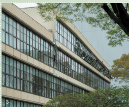
1: 一般的な建物被害。仙台市内で見られた雑壁せん断亀裂が生じた建物。| 2: 一般的な建物被害。天井等の落下(上階部)。| 3: 一般的な建物被害。ガラスの破損。
