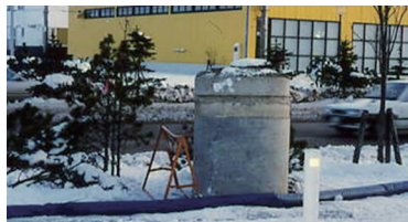
液状化により押し上げられたマンホール
